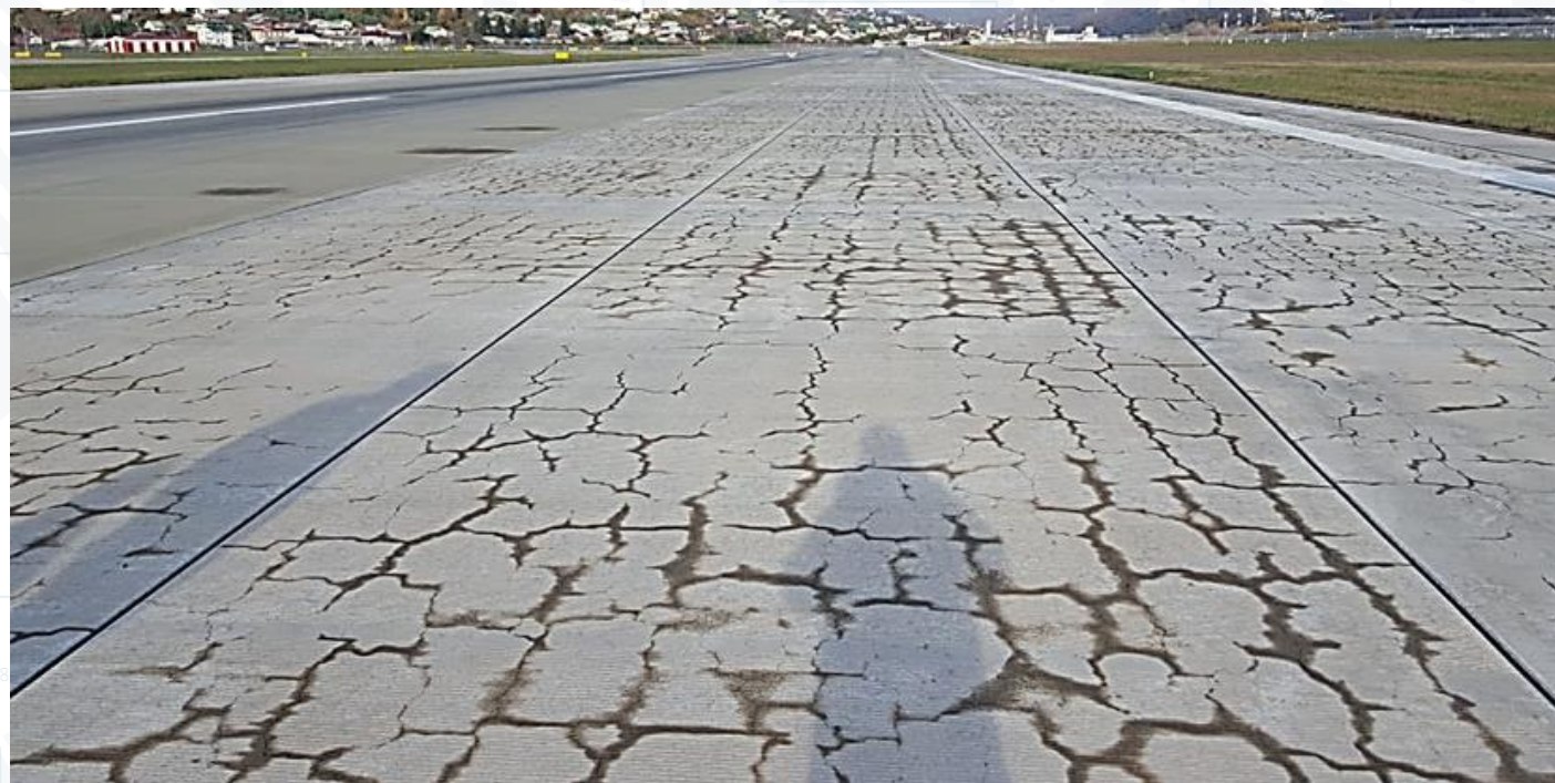
Аэродромное покрытие, поврежденное в ходе щелоче-силикатной реакции
