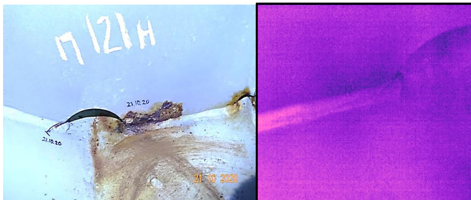
Рис. 12. Трещина большой длины: тепловые аномалии отсутствуют; длина трещины не изменилась
