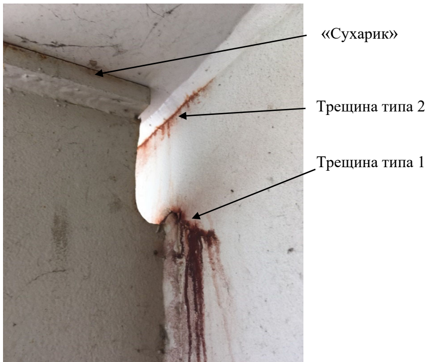
Рис. 2. Трещины типа 1 и 2
