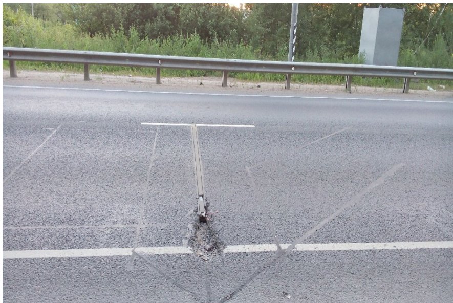
Рис. 4. Разрушение весоизмерительного датчика в результате приложения нагрузки (наезд колеса ТС) на край корпуса при недостаточной прочности основания под датчиком
