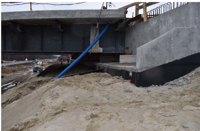
Рис. 1. Сдвиг устоя путепровода на ЦКАД
