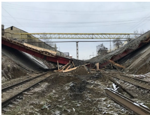
Рис. 3. Общий вид путепровода после обрушения. Вид сбоку
