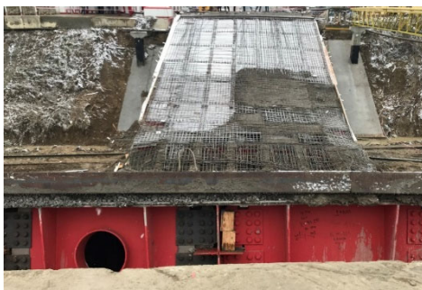
Рис. 4. Общий вид путепровода после обрушения. Вид с опоры 1
