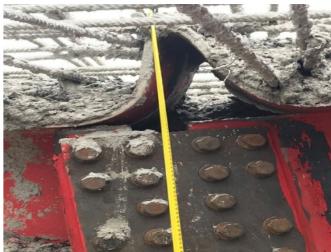
Рис. 5. Деформированный верхний пояс главной балки
