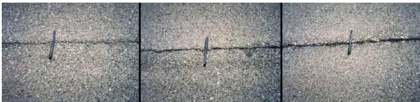
Рис.1 Прогрессирующее разрушение «технологических» трещин
