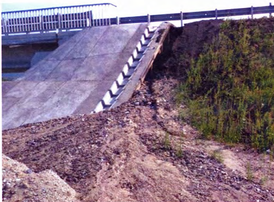
Рис. 5. Размыв откоса земляного полотна
