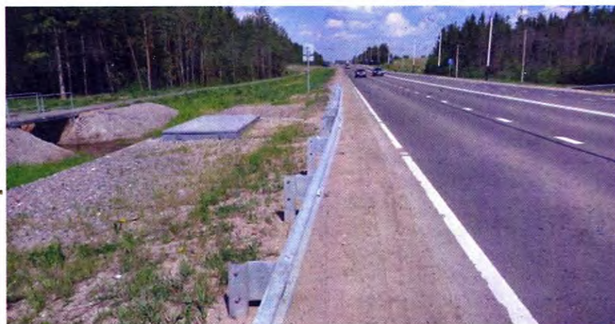
Рис. 6. Загрязнение прикромочных лотков
