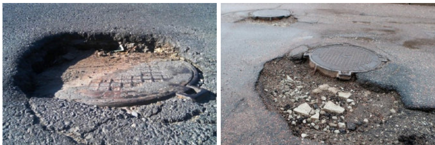
Рис. 1. Поврежденные участки дорожного покрытия в местах расположения канализационных колодцев
