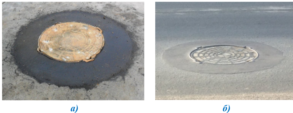
Рис. 12. Эксплуатационное состояние канализационных колодцев: а) – сразу после ремонта; б) – через 2 года
