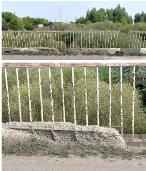
Рис. 7. Разрушение бетонного ограждения моста
