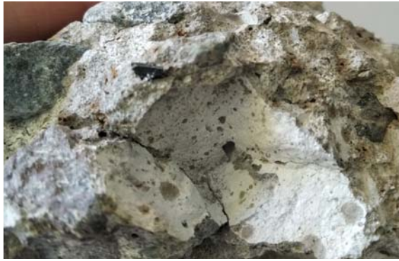
Рис. 6. Место контакта крупного заполнителя и растворной части бетона
