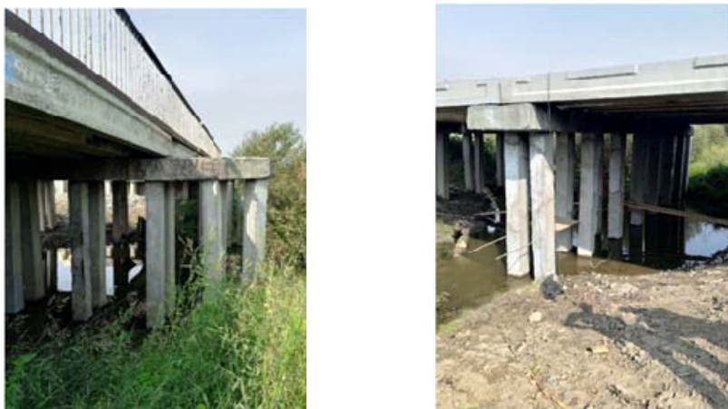
Рис. 3. Общий вид моста через р. Медведка на автомобильной дороге Юдиха – Тюменцево – Баево – Александровка – Верх-Суетка – Славгород
