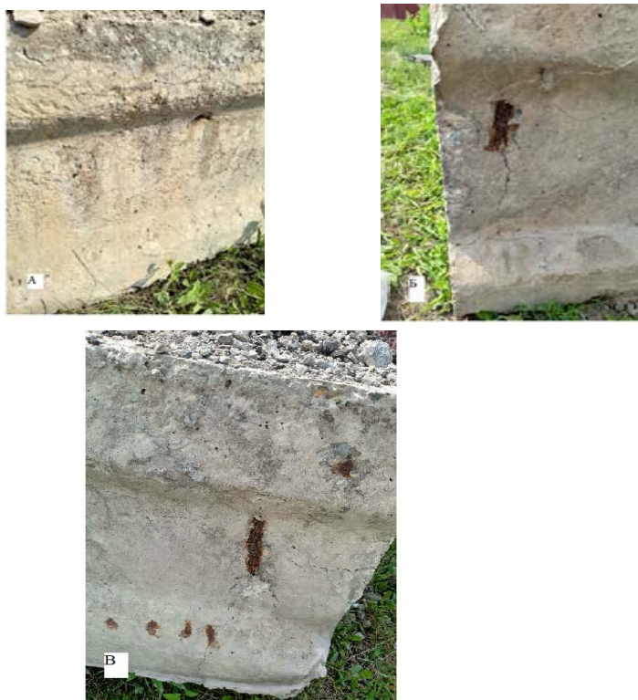
Рис. 4. Шелушение и образование белого налета (А), трещинообразование, оголение и коррозия арматуры (Б, В) на демонтированных пролетных строениях моста (балках)
