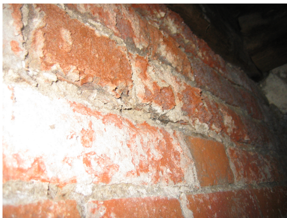
Рис. 2. Характерные признаки солевой коррозии: высолы, чешуйки, лежачки кирпича, осыпающиеся при прикосновении (степень 1) – подвальная часть кирпичного здания (г. Пенза)
