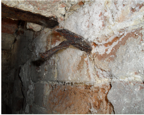
Рис. 3. На кирпичной кладке высолы и повреждения кирпичей с поверхности в виде каверн на всю площадь ложка (степень 2). Коррозия стальных элементов с расслоением металла – подвальная часть кирпичного здания (г. Пенза)
