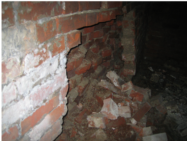
Рис. 4. Вывал наружной стены подвала с внутренней стороны из-за выпучивания; на удерживающихся участках кладки – обильные высолы (степень 3) – подвальная часть кирпичного здания (г. Пенза)
