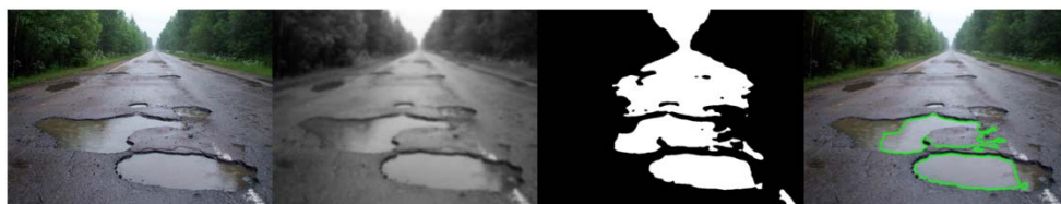
Рис. 8. Последовательная обработка изображений при детектировании дефектов покрытия
