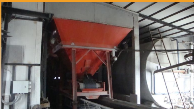
Бункера предварительного дозирования
