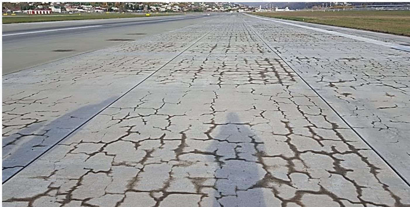
Аэродромное покрытие, поврежденное в ходе щелоче-силикатной реакции
