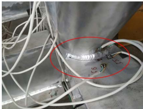
Рис. 18. Узел 2 с образовавшейся усталостной трещиной
