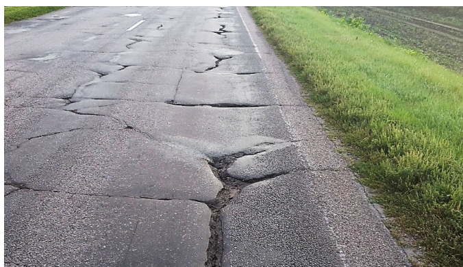
Рис. 1. Состояние проезжей части региональных дорог Волгоградской области
