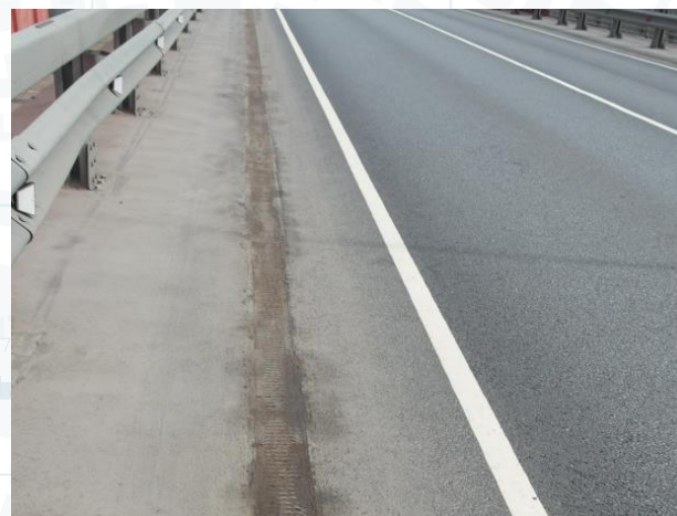
Поверхностные лотки, проблемные в эксплуатации
