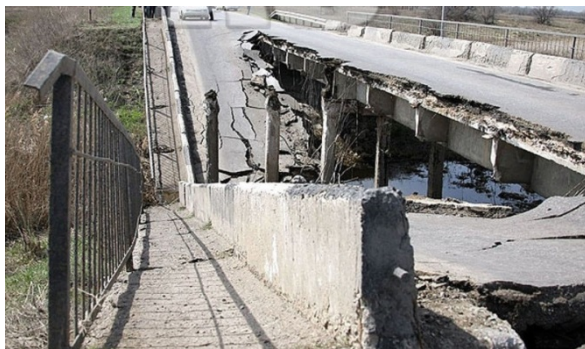
Рис. 5. Аварийное разрушение моста на автомобильной дороге Р-225 «Самара – Бугуруслан»
