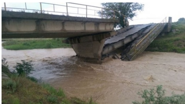
Рис. 7. Аварийное разрушение моста через р. Каскеленка (село Караой, Алматинская область)
