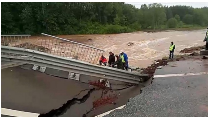
Рис. 6. Аварийное разрушение моста через р. Юг на автомобильной дороге Р-242 Пермь – Екатеринбург
