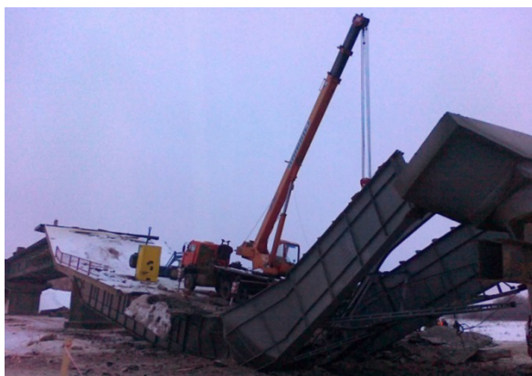
Рис. 4. Аварийное разрушение моста через р. Ворона (Воронежская область)
