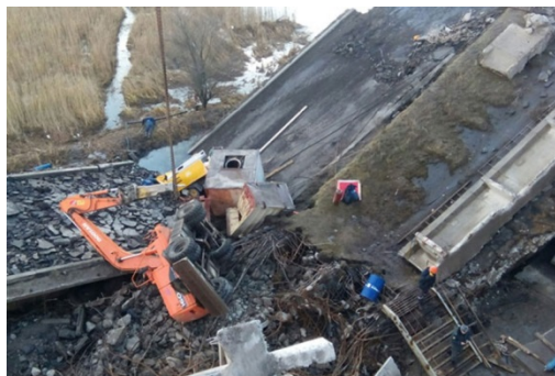
Рис. 3. Аварийное разрушение моста в г. Калининграде
