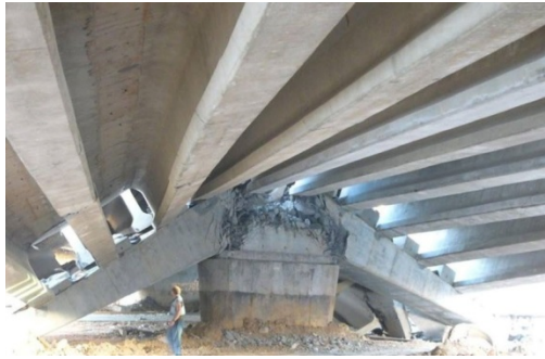
Рис. 2. Аварийное разрушение путепровода в г. Екатеринбурге
