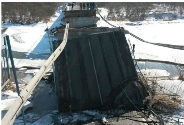
Рис. 9. Аварийное разрушение моста на автомобильной дороге Владивосток-Находка
