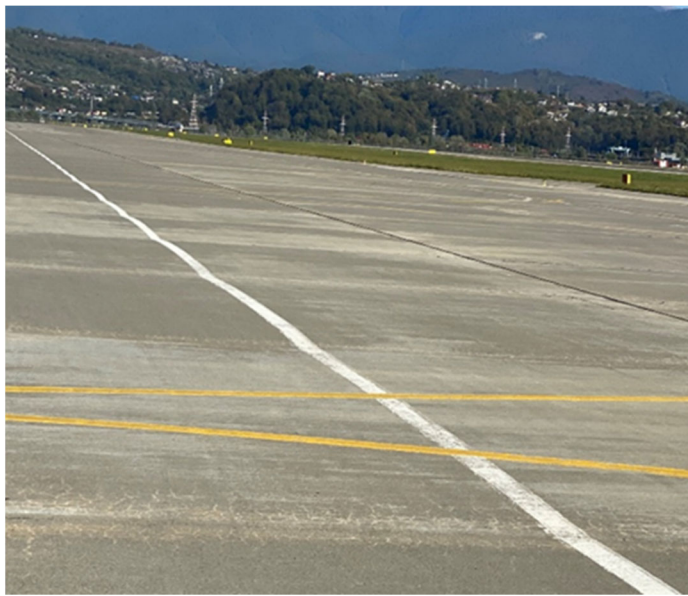
Рис. 4. Выпуклый изгиб плит покрытия
