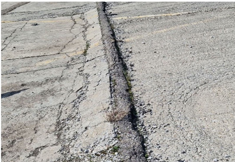
Рис. 2. Разрушение прикромочной зоны шва
