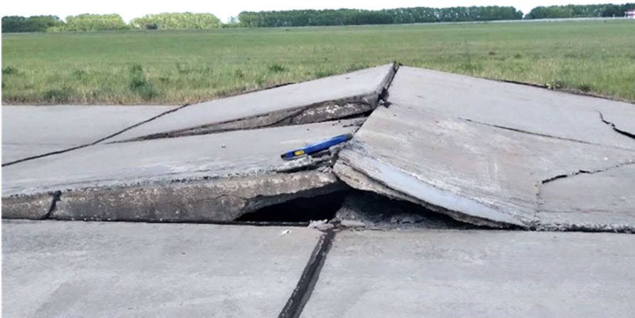
Рис. 1. Коробление плит аэродромного покрытия
