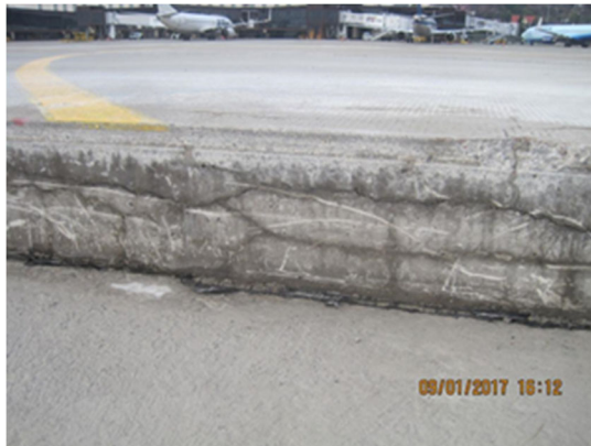
Рис. 8. Образование внутренних трещин, разделяющих плиту на слои
