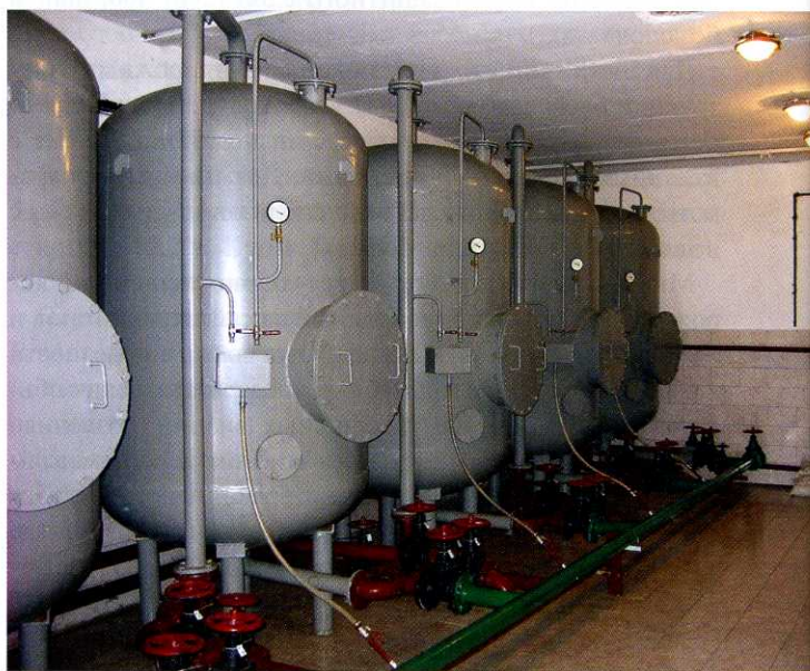
Очистные сооружения глубокой очистки
