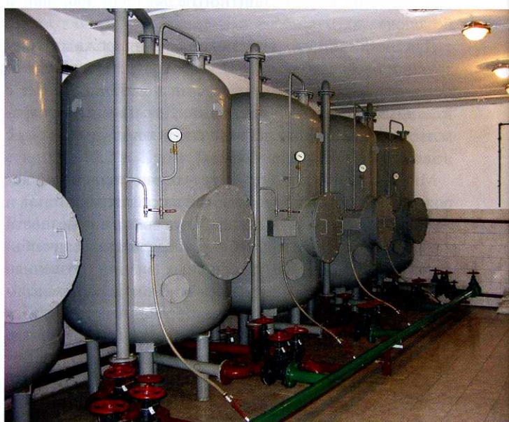
Очистные сооружения глубокой очистки
