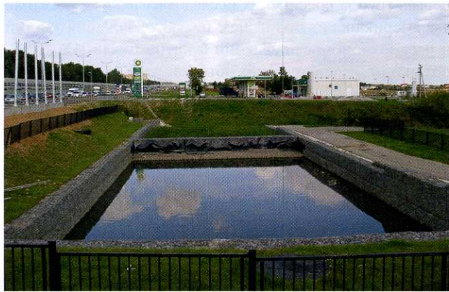
Простейшие очистные сооружения
