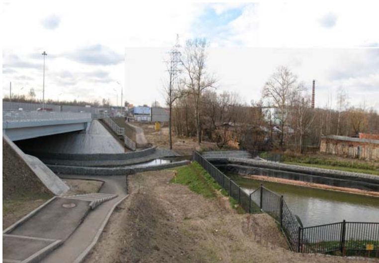
Рис. 9. Очистное сооружение (пруд-отстойник каскадного типа), автомобильная дорога М8 «Холмогоры»
