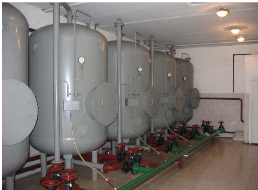
Рис. 3. Очистные сооружения индивидуального проектирования
